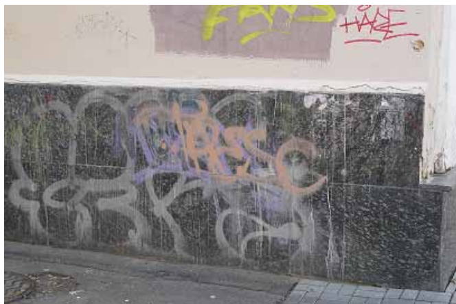
Рисунок 3. Забруднення тегами облицювання цоколю будинку, виконаного з коринського граніту (Київ)
